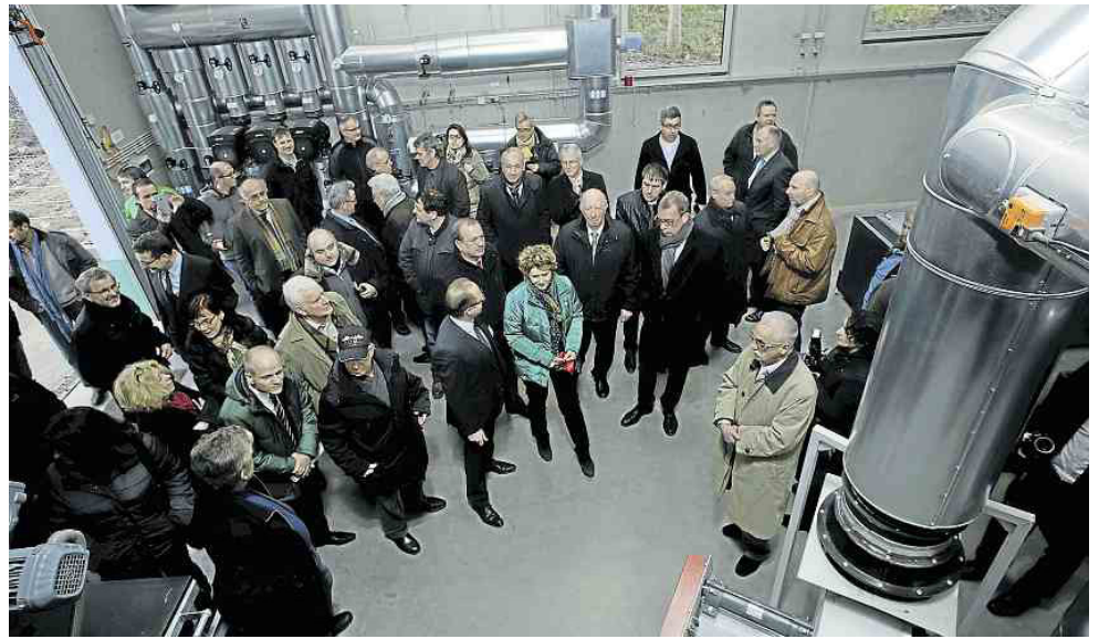
Blick ins Innere der neu gebauten Heizzentrale in der Brückener Straße: Bei der offiziellen Einweihung im Februar inspizierten die geladenen Besucher das Herzstück des nun mit einem bundesweit bedeutsamen Fachpreis ausgezeichneten Nahwärmenetzes in Birkenfeld. Foto/Archiv: Reiner Drumm
